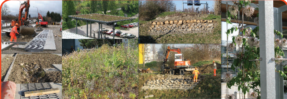
Einfahrt für Schwerverkehr mit eidechsenfreundlicher Gitterrost-Querung (Neubau)
